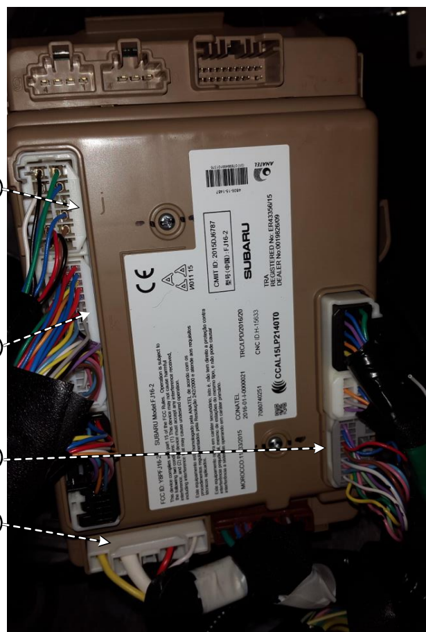
Рис. 3. Центральный блок управления. Вид с тыльной стороны.
